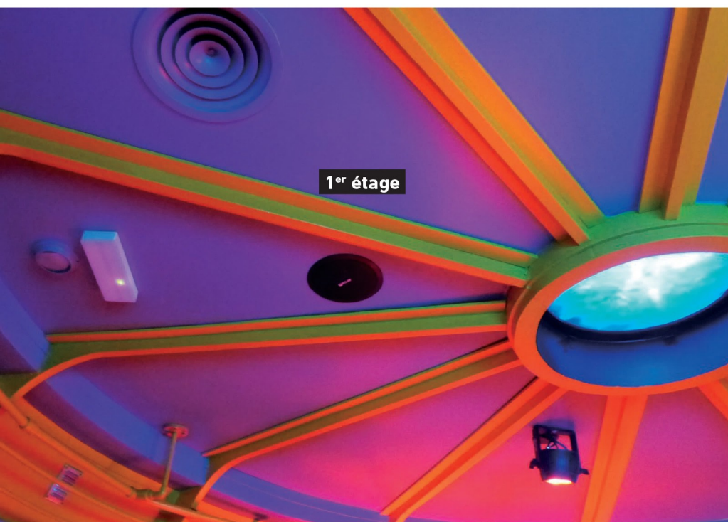
Un haut-parleur IC6 encastré dans le plafond d'un décor de sous-marin mouvant.
